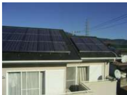
■戸建住宅での太陽光パネル
