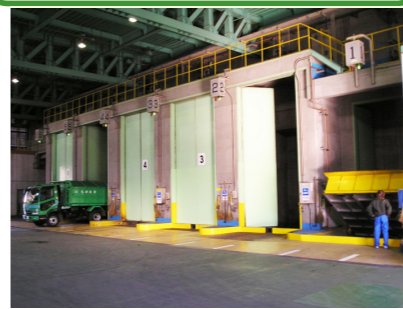
プラットフォームのごみ投入扉
