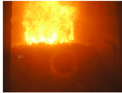
焼却している時の焼却炉内
