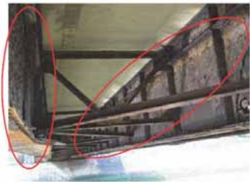
主桁の腐食が進行している
