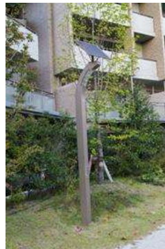
太陽光発電による防犯灯の例 (照葉のまち)
