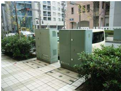
地上部に設置される地上用変圧器の色彩は彩度を抑え、設置位置も配慮する
