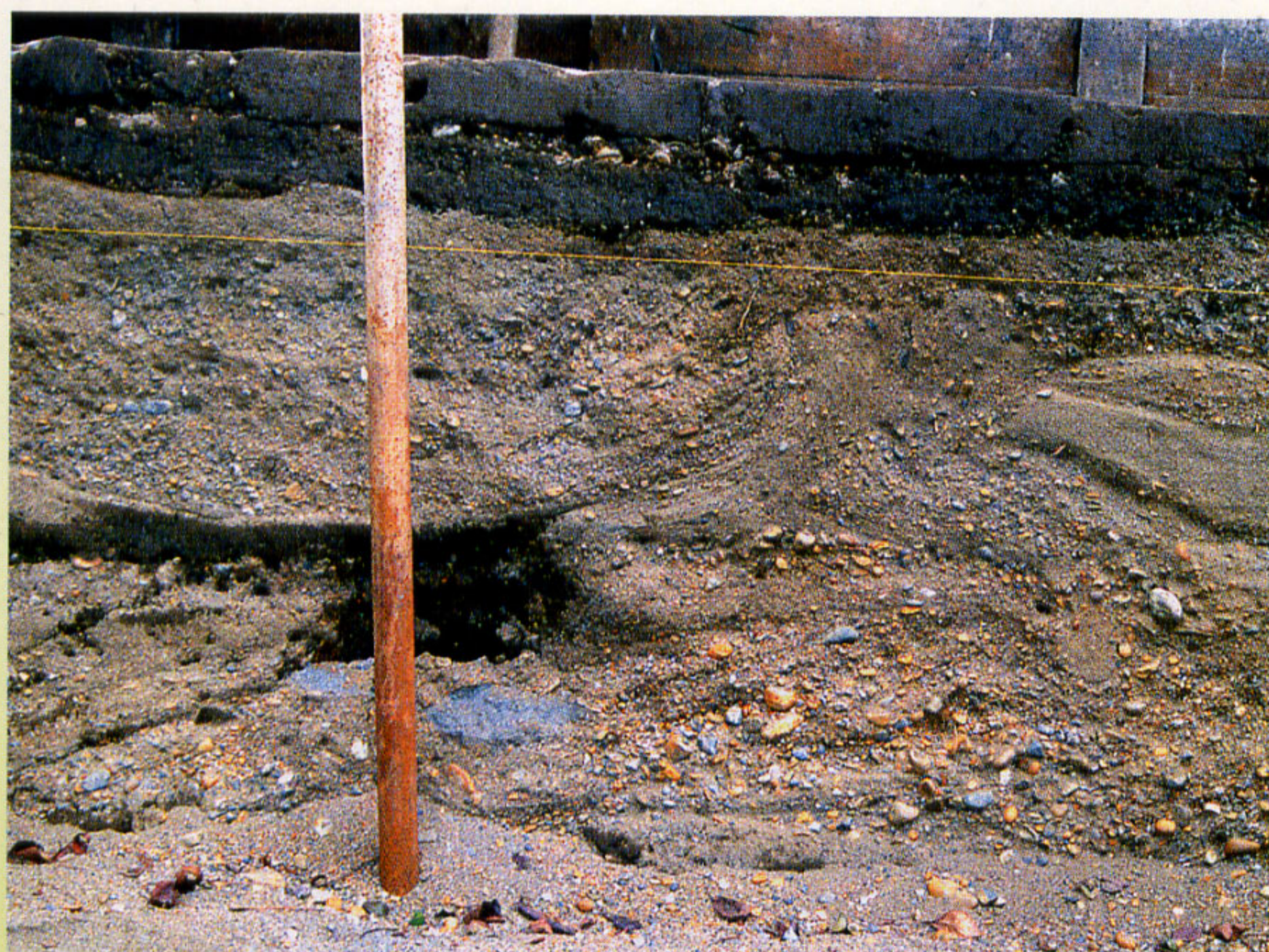
橋杭No.8北部 画面下の石は、大きさがバラバラで乱れています。液状化が起こって動いたためと思われます。
