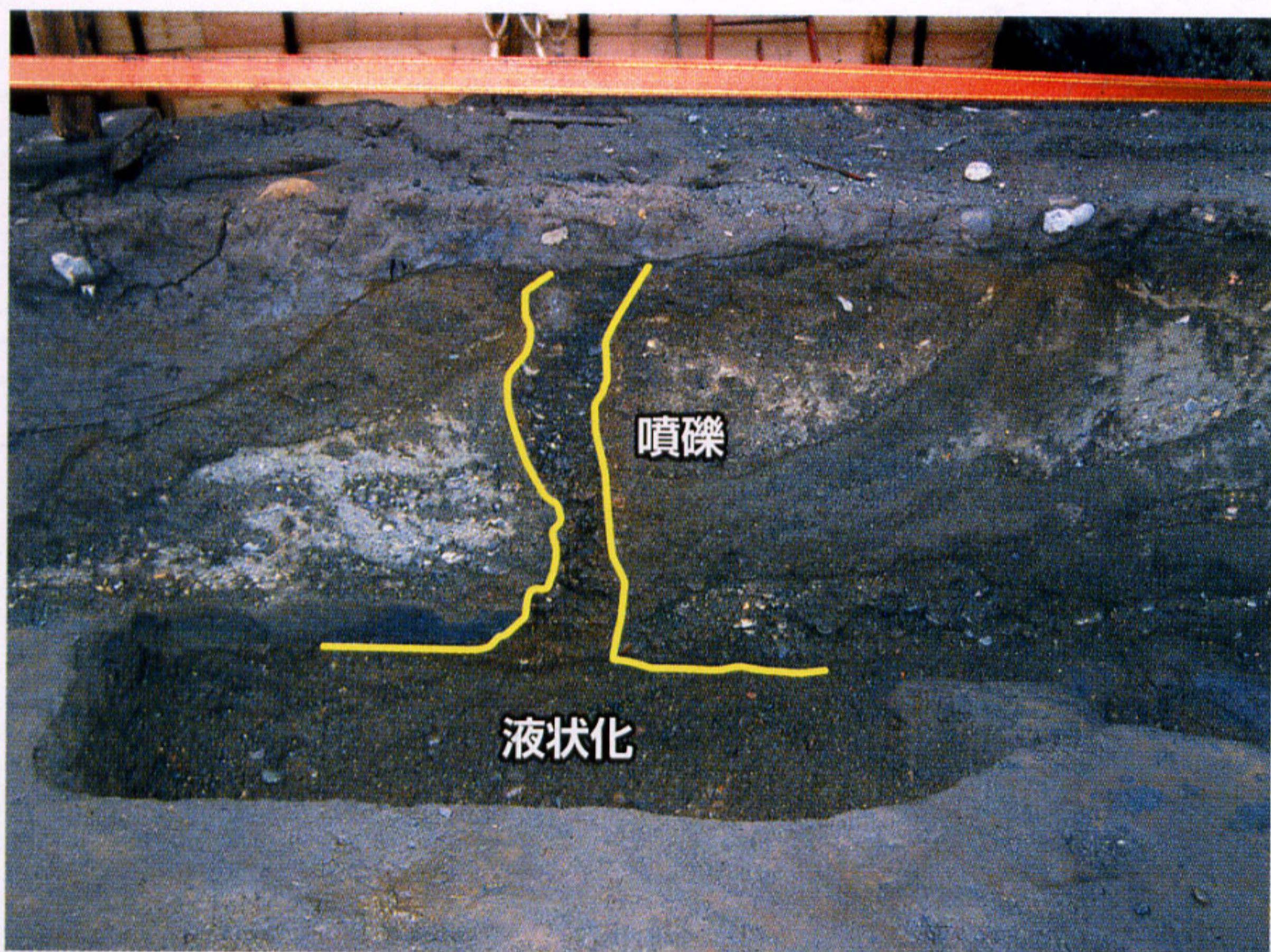
橋杭No.5付近 噴き上げている石が砂よりも大きめなので、噴礫と呼んでいます。
