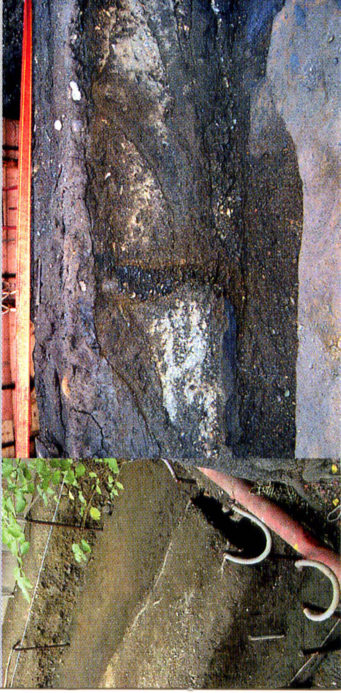
(土盛りの周堤) 液状化現象の様子
