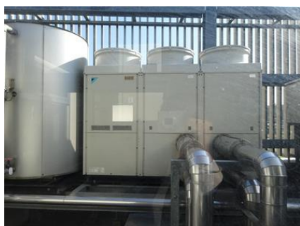
冷温水発生機
