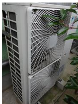
室外機に蔦が絡んでいる場合や、障害物がある場合は、速やかに除去してください。
