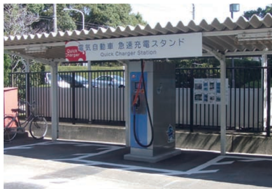
電気自動車用の充電スタンド（茅ヶ崎駐車場）
