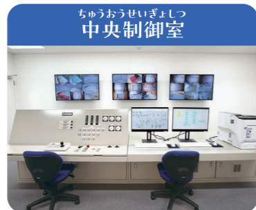
ちゅうおうせいぎしつ 中央制御室 しせつぜんたい あんぜん うご 施設全体が安全に動くようにコントロール をしています。
