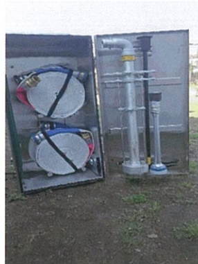
移動式ホース格納箱内部
