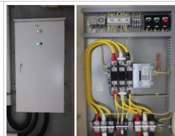
電灯電源切替盤
