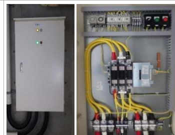
電灯電源切替盤
