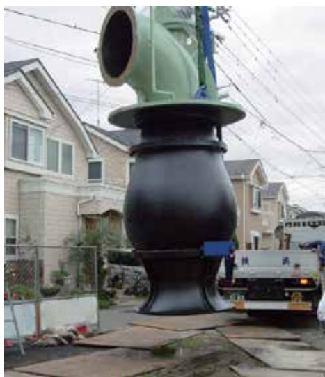
【雨水ポンプ場】 下町屋ポンプ場 口径- \phi 1000 吐出力-165 \text{m}^3/\text{min} 立軸斜流ポンプ 平成 22 年度(2010)年度供用開始
