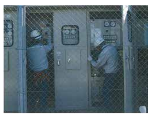
高圧受電設備の点検の様子
