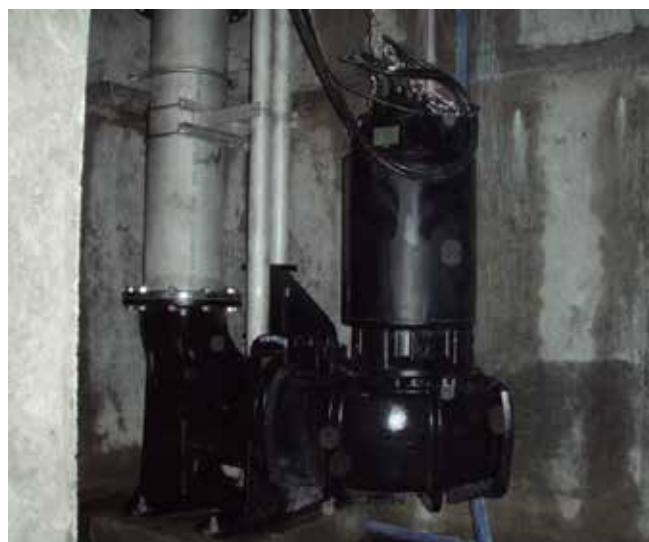
【雨水ポンプ施設】 室田橋ポンプ場 口径- \phi 350 吐出力-12.39 \text{m}^3/\text{min} 着脱式汚水水中ポンプ 平成 22 年度(2010)年度供用開始
