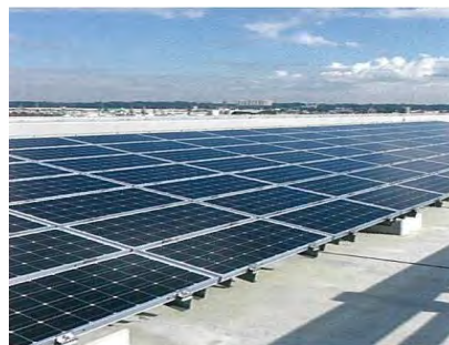
屋上の太陽光発電設備
