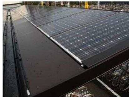
【環境エネルギーの一例】
