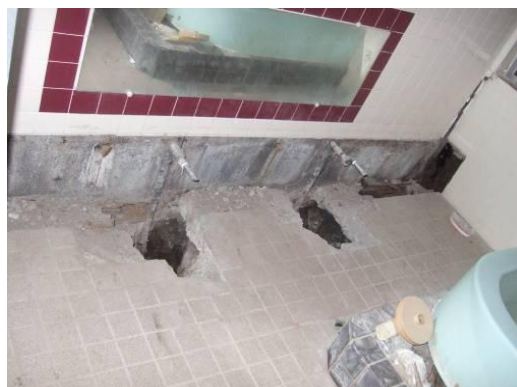
大浴場の洗い場3月まで工事待ちで修理できないとの事
