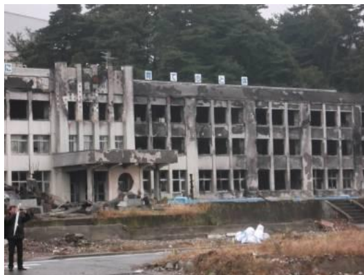
延焼した門脇小学校
