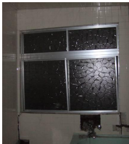
大浴場の窓 建物が傾き窓も閉まりません
