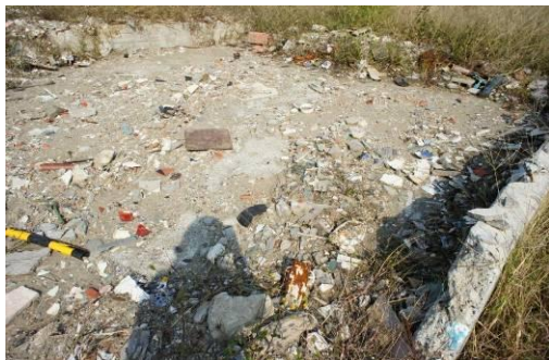
家の土台のみが残る場所に言葉が出なかった
